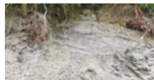
砂岩層と崩落した泥岩層
