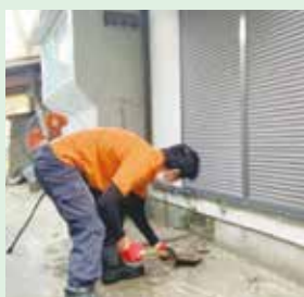
家屋からの土砂出し
