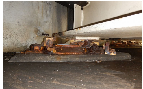
図-3 サイドブロックの破損
