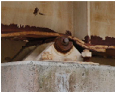
図-1 上脊の脱落
