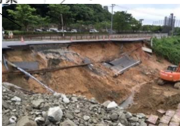
⑤R201飯塚市仁保地区の路面陥没状況
