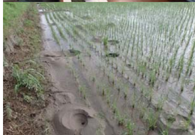
⑧筑後川支川佐田川の基盤漏水(パイピング現象)と事務所での被災対応検討
