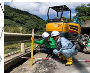
⑨R210日田市天瀬地区の道路陥没状況調査
