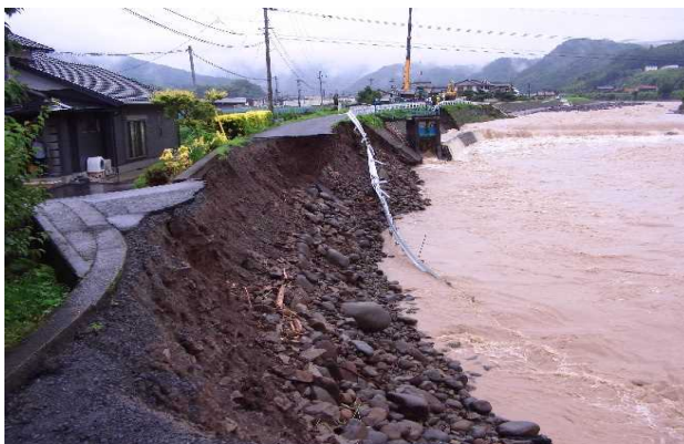
筑後川支川花月川右岸6/400付近の被災状況
